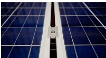
太阳能屋顶 Solar Roof
